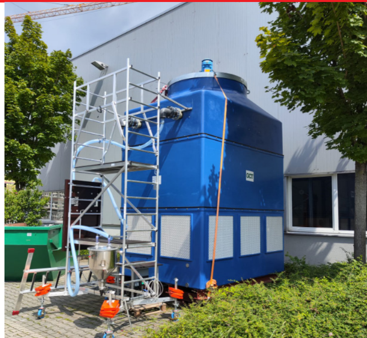
Auf dem Gelände der Greenlyte Carbon Technologies GmbH sieht man hier die Vorrichtung zur Umwandlung von CO 2 .
